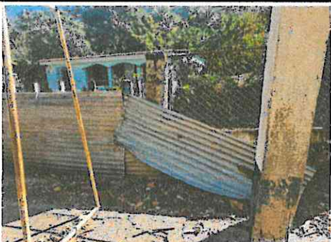
Foto 3: LA TERMINACION DE ESTE MURO TAMBIEN SERVIRIA PARA RESGUARDAR LA SEGURIDAD DE LOS NIÑOS Y NIÑAS, YA QUE DE ESA FORMA ESTARIA RESTRINGIDA LA ENTRADA A NUESTRAS INSTALACIONES. TOMARIAMOS ESTE PROYECTO COMO PRIORIDAD, POR TODA LA VIOLENCIA QUE VEMOS QUE IMPERA EN NUESTRA
