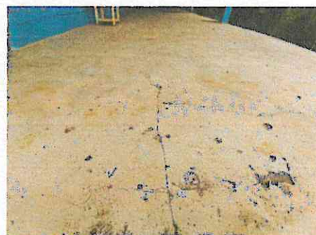
Foto 4: SE CUENTA CON VARIAS AREAS DEL PISO DE LOS MÓDULOS 2,3 Y 4 DEL ESTABLECIMIENTO, QUE SE ENCUENTRAN DAÑADAS, EL OBJETIVO ES SUSTITUIRLO POR PISO CERÁMICO.
