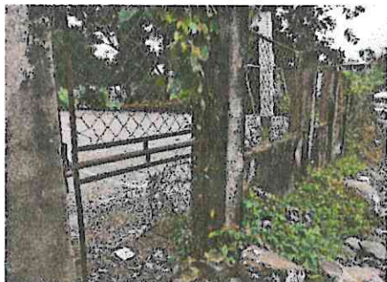
Foto 1: LA MAYA CON LA QUE CUENTA EL PEQUEÑO PORTÓN COLOCADO EN LA ENTRADA DE LA CANCHA DEPORTIVA DEL ESTABLECIMIENTO SE ENCUENTRA DAÑADA AL IGUAL QUE EL RESTO DE MAYA DE DICHA CIRCULACIÓN.
